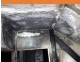
Požár podkrovního bytu
